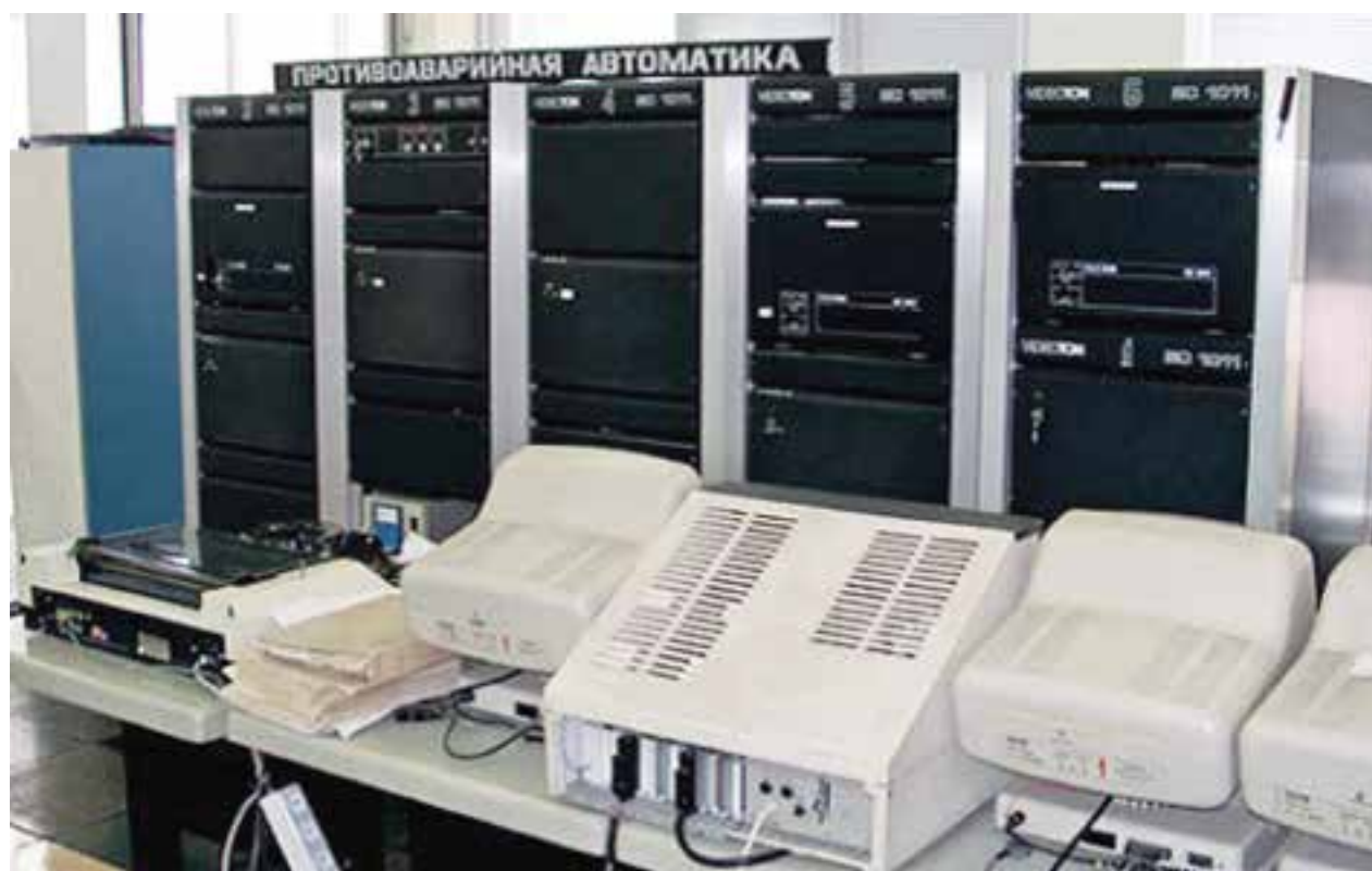
ЭВМ «Видеотон» ЕС-1011 – основа Централизованных систем противоаварийной автоматики Объединённых энергосистем в 1990-е годы
