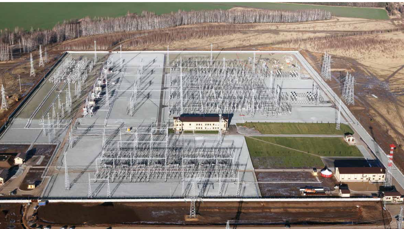
ПС 500 кВ «Щёлоков» – первая подстанция в ЕЭС России такого класса напряжения, на которой реализовано дистанционное управление оборудованием из диспетчерских центров АО «СО ЕЭС»
